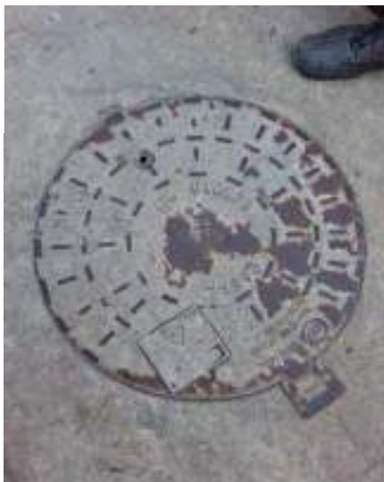
Figura 48- Esgotamento Sanitário na Rua Pajuçara, Guaxuma/AL.
