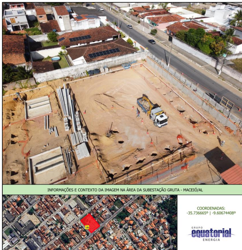
Figura 4: Imagem aérea da SE.
