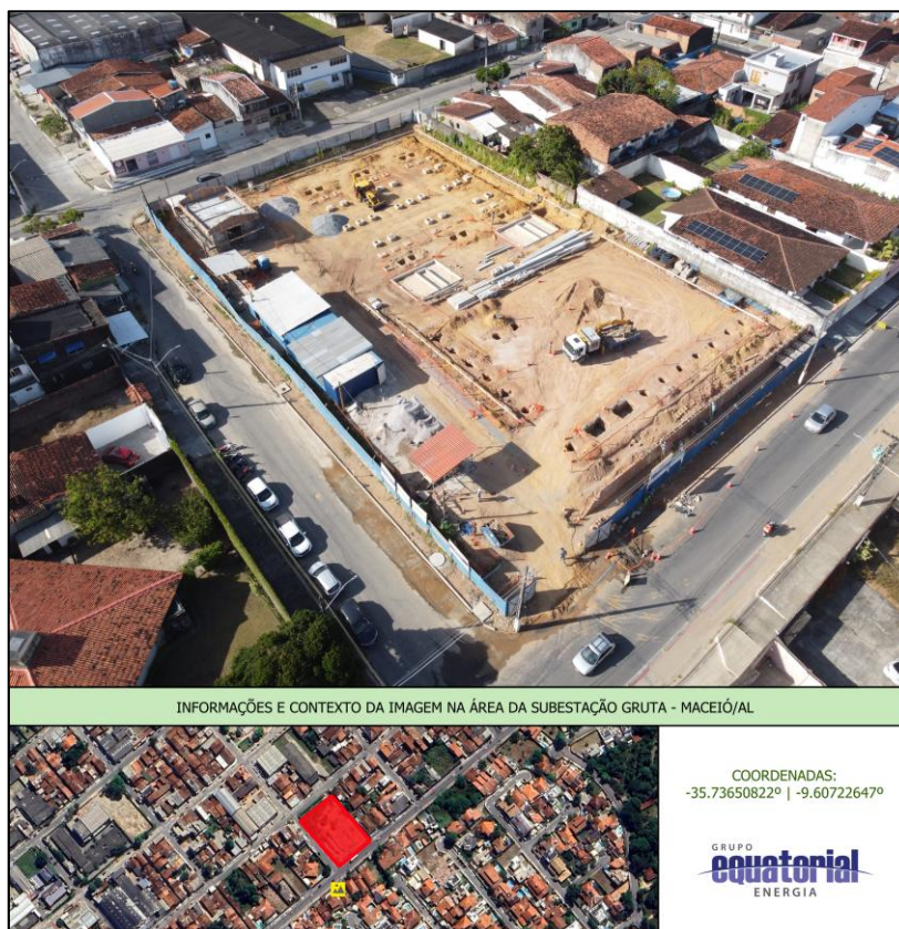
Figura 5: Imagem aérea da SE.
