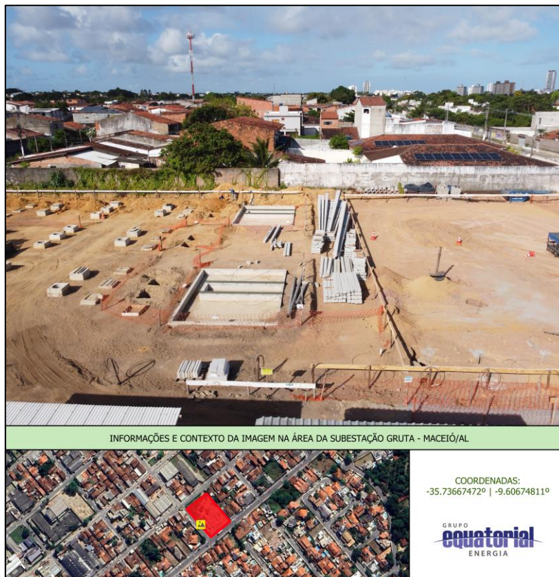
Figura 2: Imagem aérea da SE.
